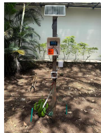
Fig. 8 Nodo de sensores para instalación en campo.
