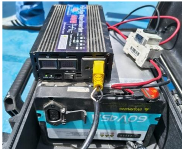
Fig. 8 Inversor, llave termomagnética e inversor
