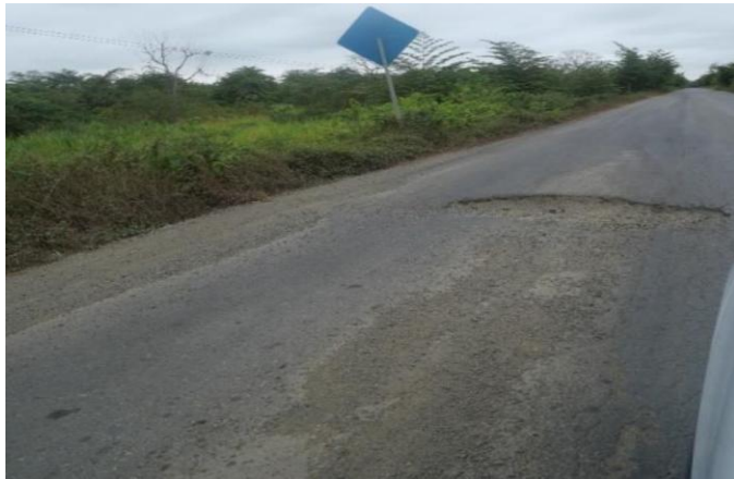
Fig. 3 Hundimiento en la vía
