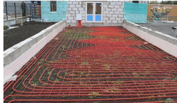
Fig. 1 Sistema de calefacción de suelo mediante cable eléctrico que permite mantener una temperatura del suelo óptima para los cultivos.
