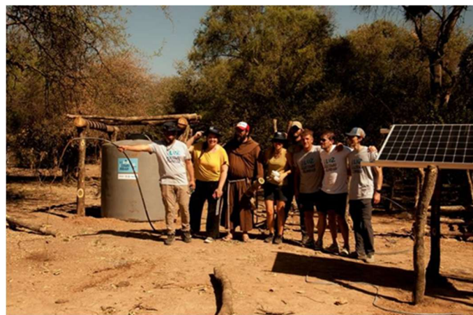
Fig 3. Panel fotovoltaico y tanque de almacenamiento en la comunidad Wichí La Cortadera.
