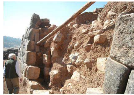
Fig. 5 Muro inca colapsado. Adaptado de [10].
