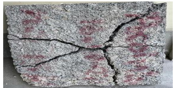
Fig. 8 Ruptura del panel de shotcrete.
