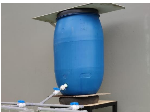
Fig. 5 Tanque de almacenamiento del agua contaminada.
