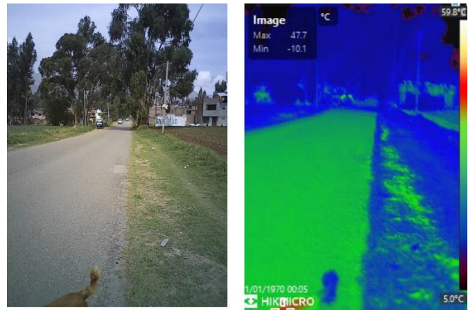
Fig. 7 Imagen termal para una vía no pavimentada en el AMH
