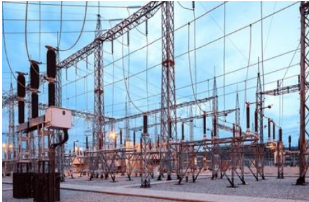
Fig. 4 Ejemplo de nodos IoT en una subestación eléctrica
