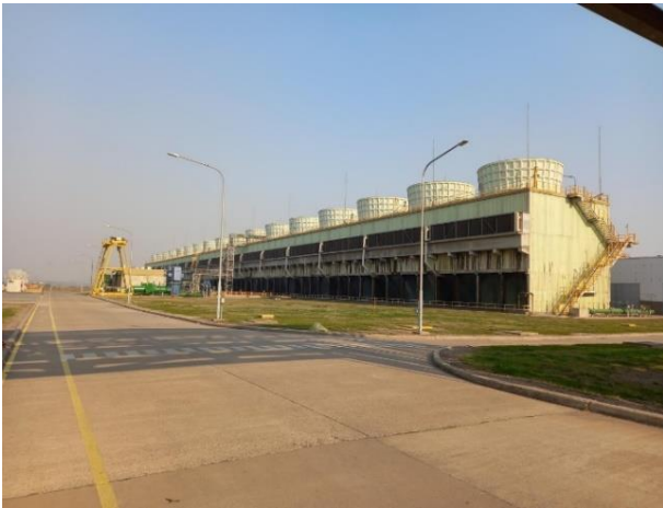
Foto 2: Vista completa de la torre de enfriamiento 260 mts largo, 17 mts de ancho con 17 módulos. Ref. [6]
