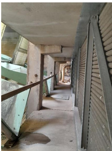
Foto 3: pasillo que comunica los módulos de la torre de enfriamiento entre la parte seca (derecha) y la parte húmeda (izquierda). Ref. [6].
