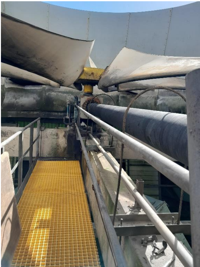
Foto 4: conjunto mecánico de cardan de fibra de carbono, diferencial con reductor mecánico de velocidad para el cambio de sentido de giro de las aspas de un ventilador de la torre de enfriamiento. Ref. [6]
