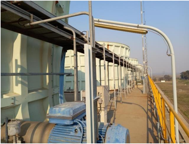
Foto 1 Motores de 200 Kw que mueven las aspas de los ventiladores. Ref [6].
