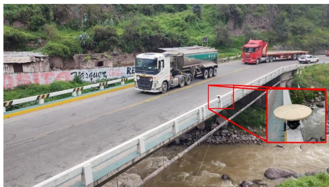
Fig. 2 Instalación de la antena geodésica GPS en la baranda de concreto del puente.
