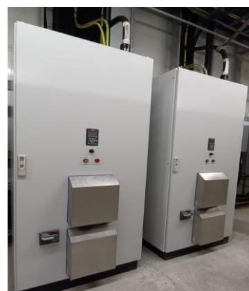
Fig. 6. Foto de paneles con variadores de frecuencia y arrancadores redundante
