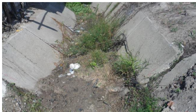
Figura 1. Canal con obstrucciones. Fuente: Propia
