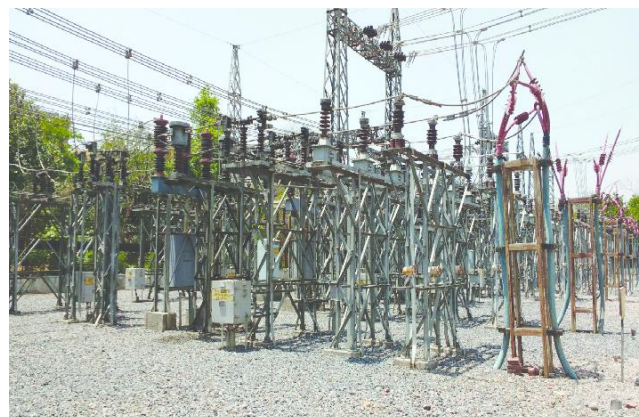
Fig. 2 Subestación aislada en aire y zona de puesta a tierra con superficie de grava Fuente: Referencia [17]
