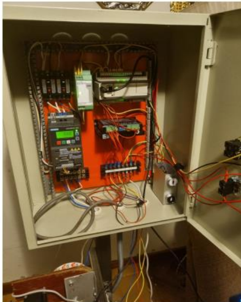
Fig. 16. Vista interna del tablero de control
