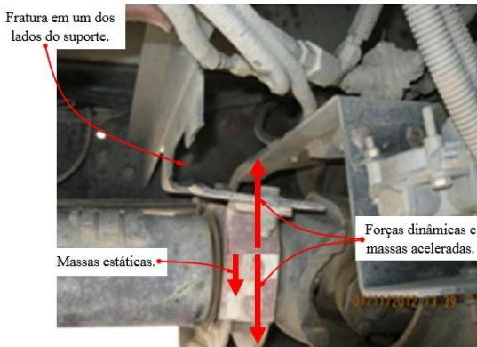
Fig. 3 – Suporte do mancal onde ocorreu a falha.
