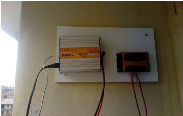
Fig. 2 Inversor y transformador instalados
