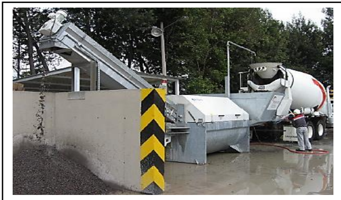
Fig. 5 Estación de Lavado. Fuente: Planta de Hormigón Holcim Ecuador S.A.
