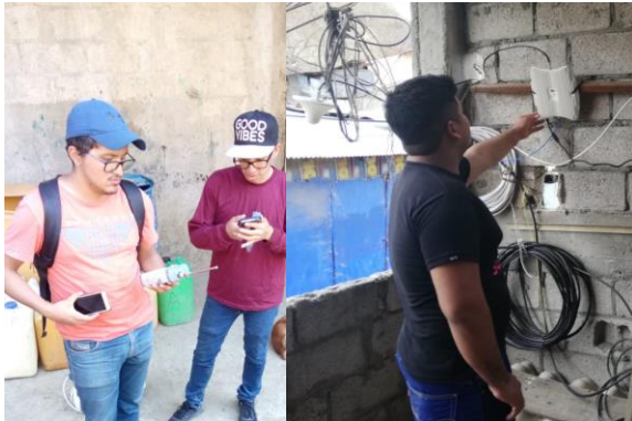
Fig. 11 Pruebas de llamada e instalación final del dispositivo repetidor.
