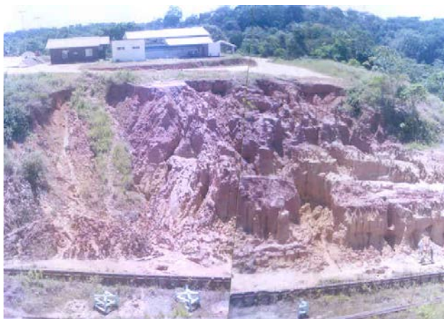
Fig. 6 Talud totalmente erosionado por efecto de la lluvia intensa
