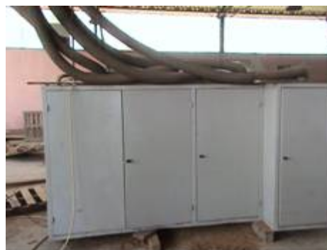
Figura 13: Sistema de exaustão acima da máquina
