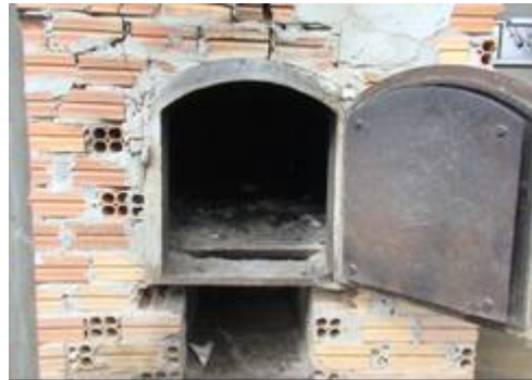
Figura 9: Entrada para resíduos de madeira
