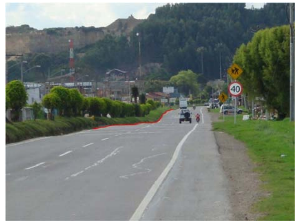
Figura 6. Patologías asociadas a procesos de desecación en vías pavimentadas.
