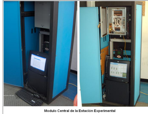
Figura 4. Vista de la estación experimental para el diagnóstico de transformadores
