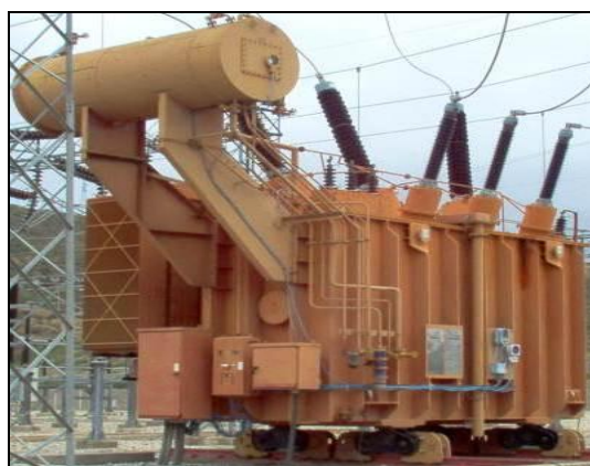
Figura 2. Autotransformador N° 2 de la Subestación Barquisimeto, Venezuela.
