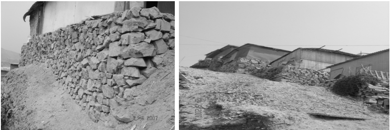
Figura 5.1: Viviendas cimentadas sobre piedras apiladas sin cementante.
