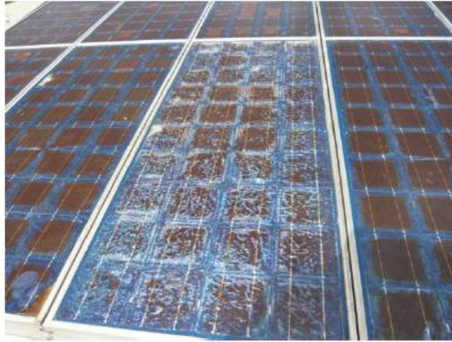
Figure 6: Detalle de módulo fotovoltaico con cristal roto. Note además la mancha marrón generalizada en los módulos circundantes
