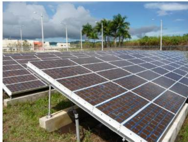
Figure 3: Vista parcial del parque de arreglo fotovoltaico evaluado al presente.
