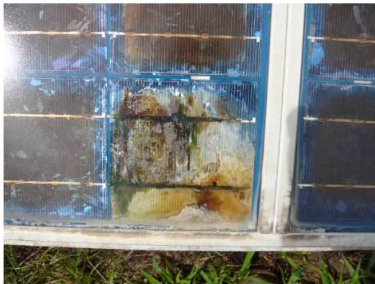
Figure 9: Detalle de celda afectada por intrusión de humedad. Note los daños a la celda y cintas de conducción eléctrica.
