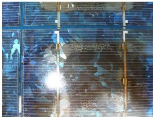
Figure 5: Detalle de mancha marrón generalizada en módulo. Note intensidad de la mancha es mayor en el centro de la celda
