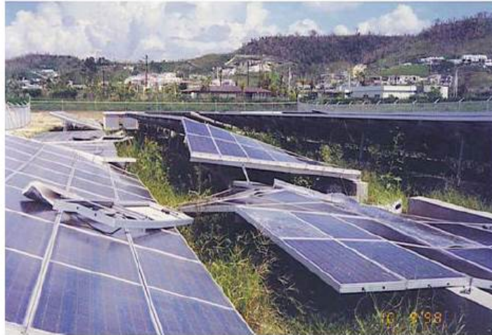
Figure 2: Módulos fotovoltaicos y soportes afectados por vientos huracanados durante el Huracán Georges en 1998.
