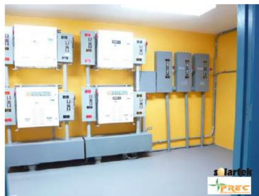
Figure 4: Vista parcial de los equipos de manejo de energía (inversores y desconectivos) del sistema fotovoltaico evaluado al presente.
